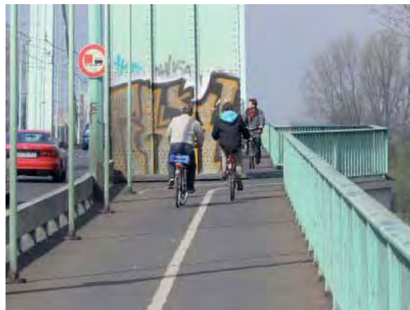
Gegenwärtiger Zustand der Mülheimer Brücke: Pfeiler und schmale Radwege machen Gegenverkehr riskant.
