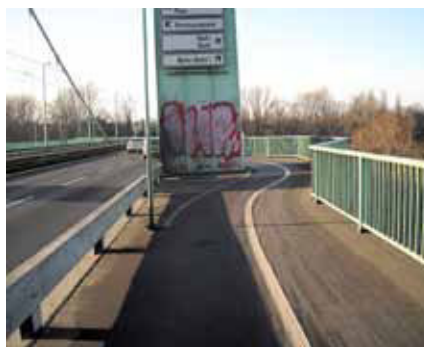
Mülheimer Brücke: kritische Pylons
