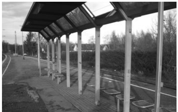
Löcher oben und unten: Der Bahnsteig des Bahnhofs (Lünen-) Preußen mit Schlaglöchern und undichtem Dach.
