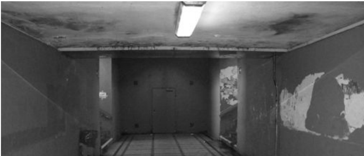
Wenig einladend: Der Tunnel-Zugang zum Bahnsteig am Bahnhof Preußen in Lünen.
