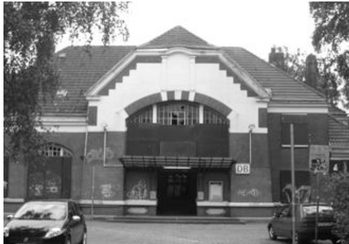
Das Bahnhofsgebäude in Kurl ist über 100 Jahre alt. Das sieht man Dortmunds einzigem Bahnhof mit Jugendstileinflüssen leidet an. Er wird seit Jahren nicht genutzt und verfällt zunehmend. Foto: Lins
